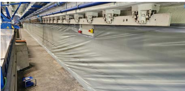
Großflächige Sicherungsmaßnahme, um weitere Freisetzung von Schimmelpilzsporen zu unterbinden.
