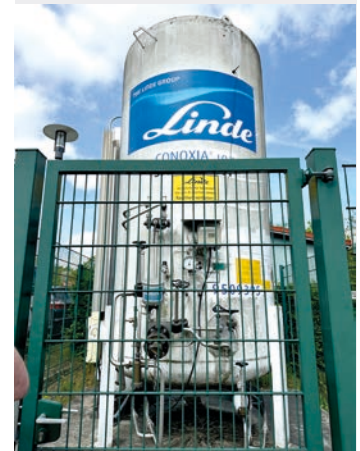
Tank-/Verdampferanlage zur Lagerung und Verdampfung von medizinischem Flüssigsauerstoff auf dem Krankenhausgelände.
