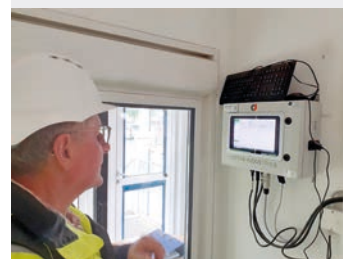
Anzeigeeinheit einer Portalmeßanlage
