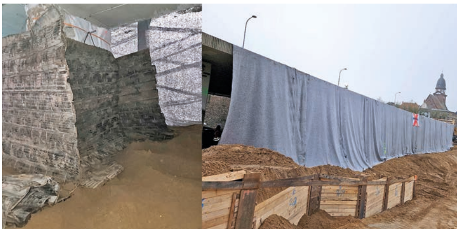
Zusätzliche Absicherung durch Gummireifenmatten (links) und Vliesvorhänge (rechts).
